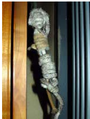
Cordons de câbles électriques
